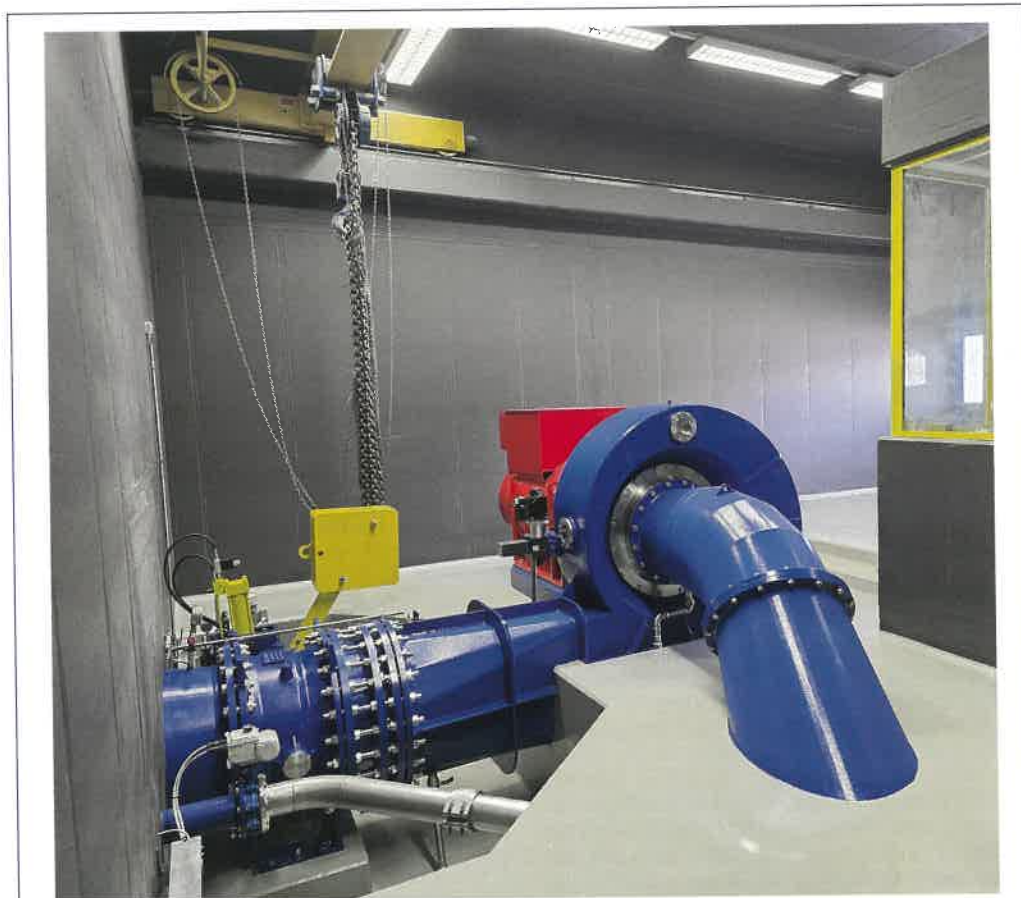
Abb. 6: Anlagentechnik bereit zur Stromproduktion
