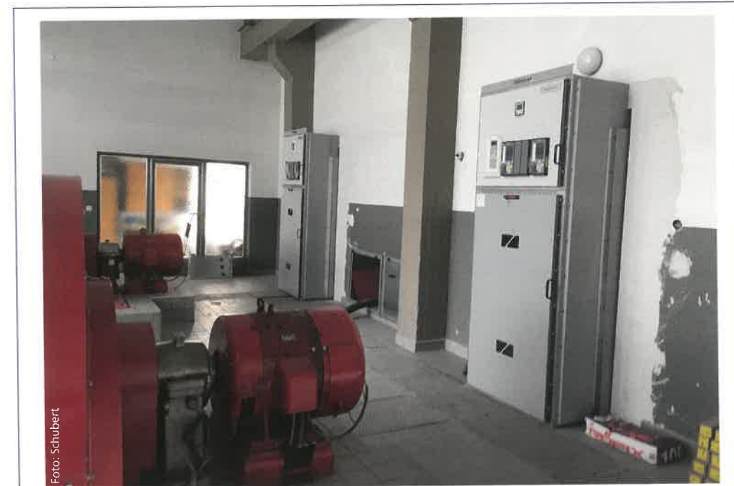
Die kompakten Generator-Zellen wurden platzsparend in den vorhandenen Mauernischen platziert.
