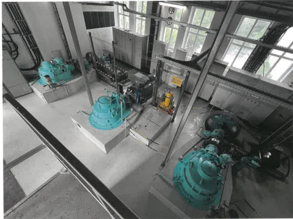
Die Halle über dem Wehr mit Generatoren und drei Turbinen von Voith.
