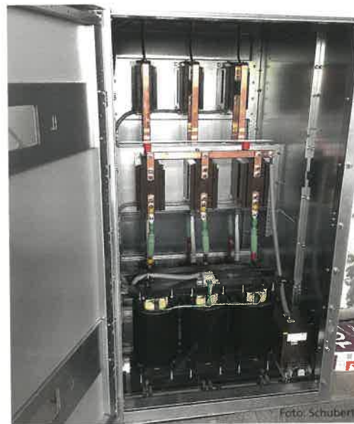
Mittelspannungsteil mit Wandlern und Trafos
